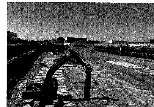
【春日井浄水場
